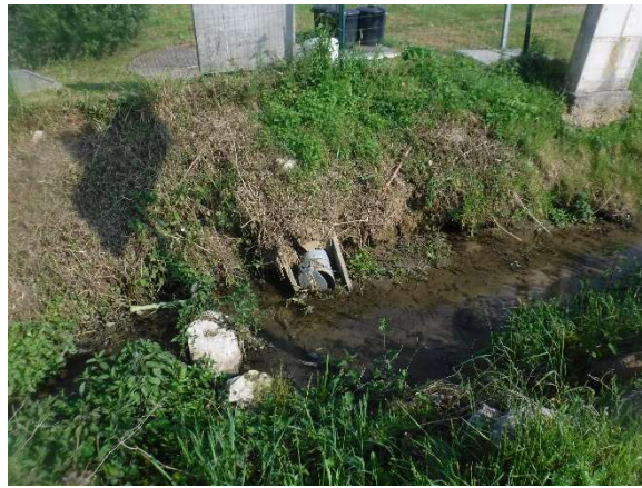
Rejet de la station d'épuration de Dampierre en Graçay dans la Prée
